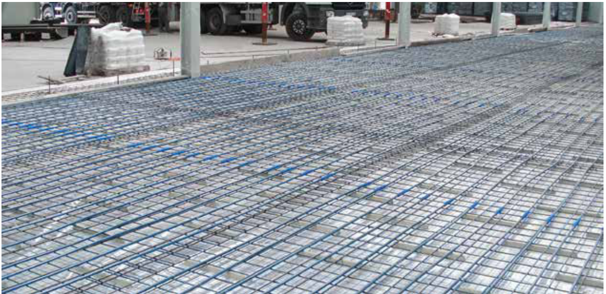
Рис. 4. Система напольного отопления в складском помещении при использовании труб bluePERT и системы крепления труб KAN-therm NET.
