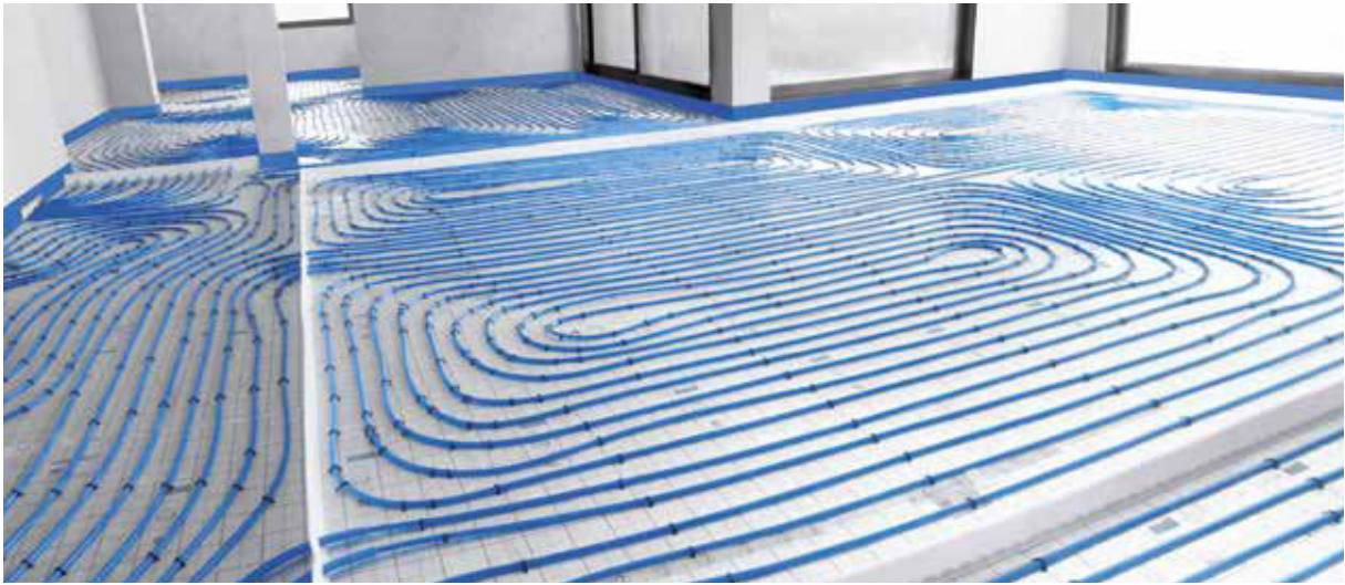
Рис. 25. Напольное отопление/охлаждение, выполненное в системе KAN-therm Tacker
