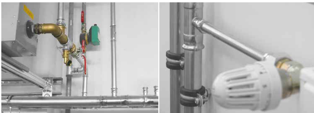
Примеры монтажа оборудования KAN-therm Steel
