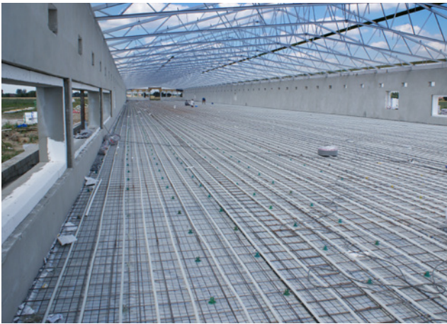
Система KAN-therm – отопление птичника (2500 м 2 ) в условиях содержания птицы на подстилке – Польша, Брожово Велке.
