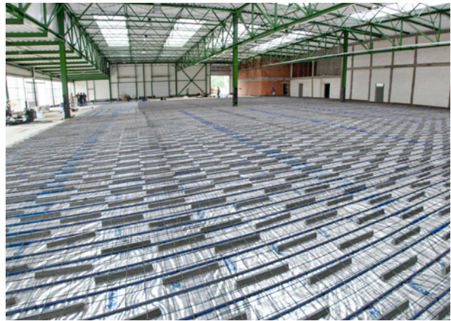
Система KAN-therm – панельное отопление (1500 м 2 ) в перевалочном цехе рассады салата - Польша, Косув.
